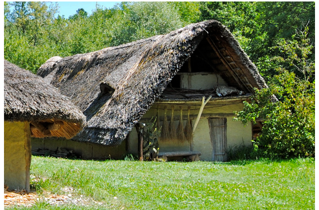
Le toit de l'atelier se rapproche du sol...
